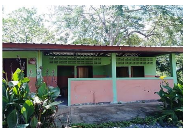
ส้วม สปข.๖๐๑/๒๖ ปีที่สร้าง ๒๕๓๔
