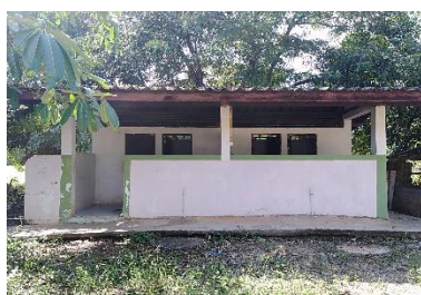
ส้วม สปข.๖๐๑/๒๖ ปีที่สร้าง ๒๕๒๖
